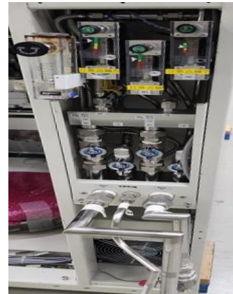
O. Cooling Unit
