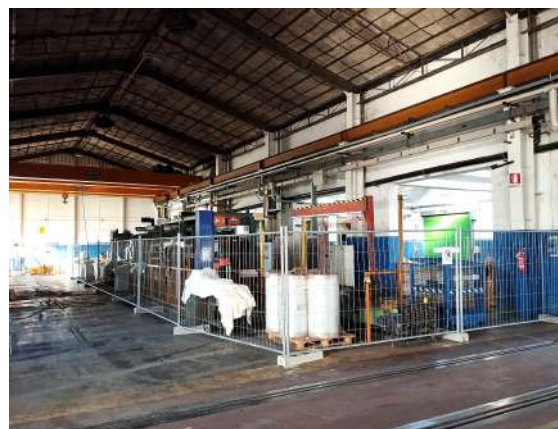
Vista linea e area impilaggio / Line and stacking area view
