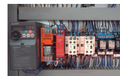
Quadro elettrico incorporato
